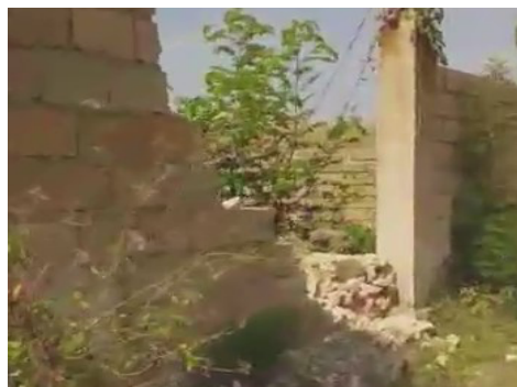
Trou effectué dans le mur d'enceinte du terrain de Léogane
